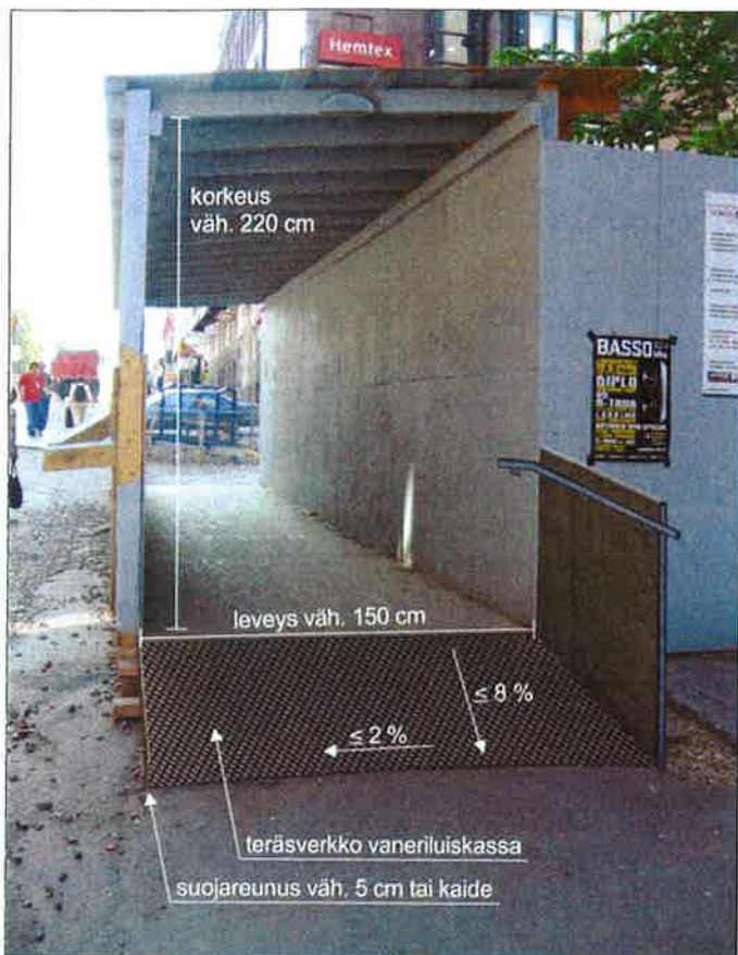
Kuva 4. Esimerkki katetusta työmaa-aikaisesta jalankulkuväylästä ja luiskasta. Luiskan sivuseinäke ohjaa kulkijan selkeästi pois ajoradalta. Teräsverkko vaneriluiskan päällä toimii erityisesti talviolosuhteissa.
